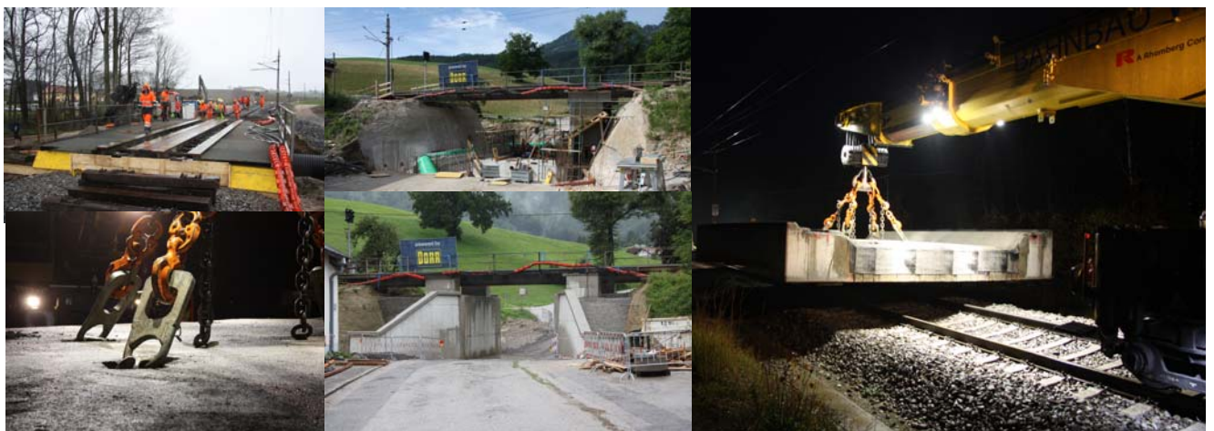
2014 ÖBB-Strecke Linz-Selzthal, Brücken und Unterführungen in km 30.184, 58.241 und 58.665 Tragwerkserneuerungen teilweise mit Einhub des fertigen Tragwerkes
